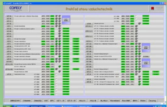
Ondrej Nepela Ice Rink Alarm Monitoring
